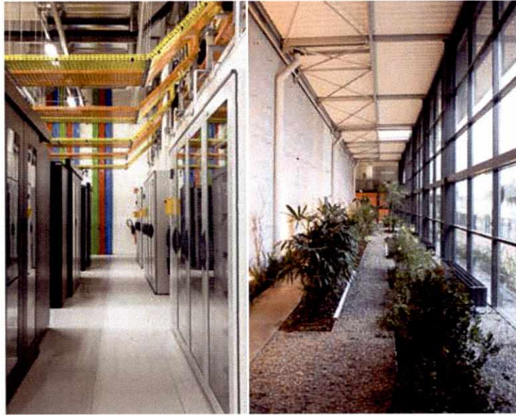
Şekil 3.3 Yeni Telecity Paris veri merkezinde ısının yeniden kullanımı
